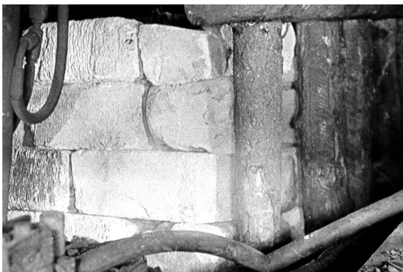
Рис. 2 – Крепежная конструкция из газобетонных блоков в виде тумбы (сопряжение 15-й восточной лавы пласта l_1 с вентиляционным штреком на шахте «Красногвардейская»)
